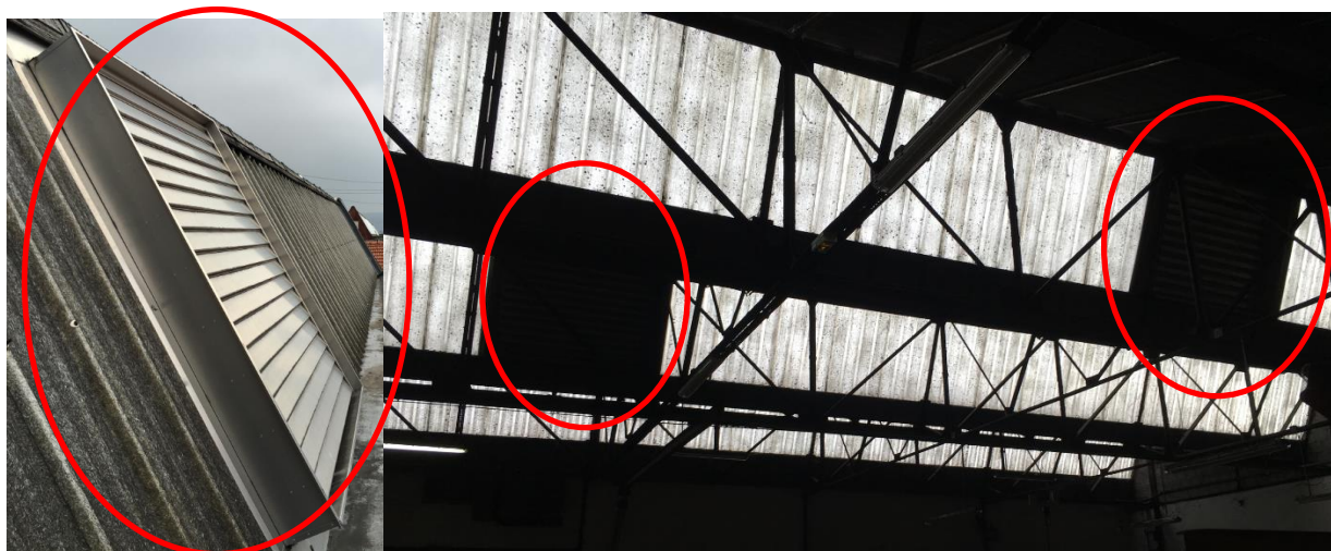
PHOTO 1 : EXUTOIRES A LAMES AVEC VENTILATION NATURELLE
